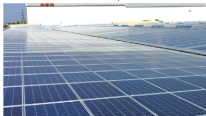
光伏一体化屋面
